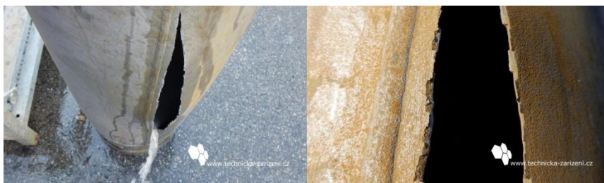
Obr.4. Houževnatý lom na válcové tlakové nádobě
